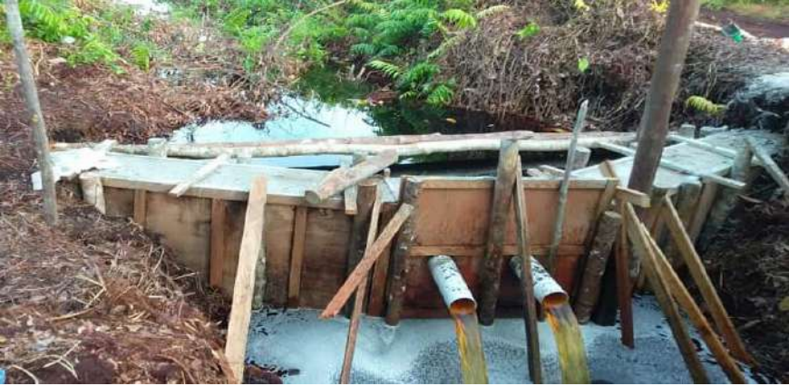
Gambar 9. Sekat kanal dengan satu lapisan dinding beton yang disepakati bersama anggota masyarakat dengan tipe yang berkualitas tinggi.
